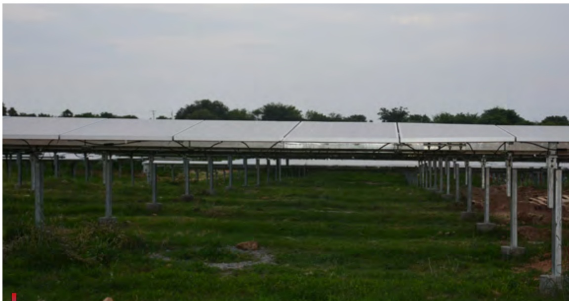
Solar Plant, JSW Neo
